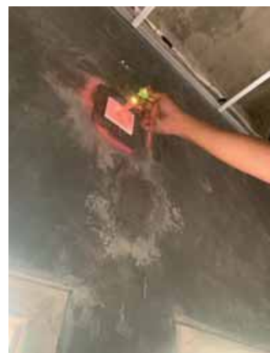
Gambar 4. Uji coba sumber listrik yang telah dilakukan pemasangan stop kontak
