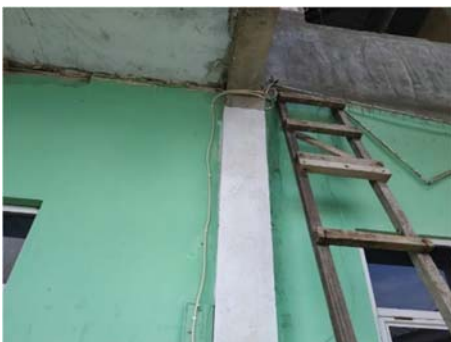
Gambar 3 Kabel tidak standar dalam rumah tahfiz quran
