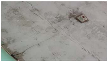
Gambar 1. Lokasi kabel yang tidak standar
