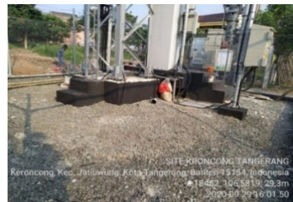
Gambar 15. Menara BTS Menggunakan Kabel BC Spiral
